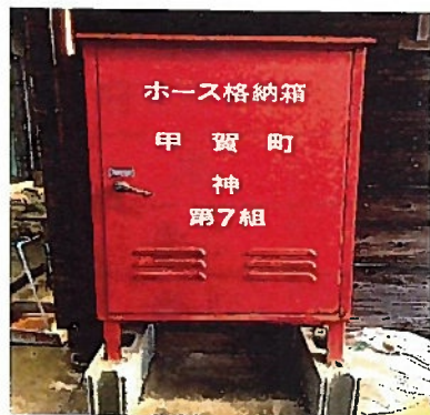
①近くのホース格納箱を開ける
