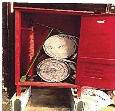
②ホース類一式を消火栓の場所へ運ぶ
